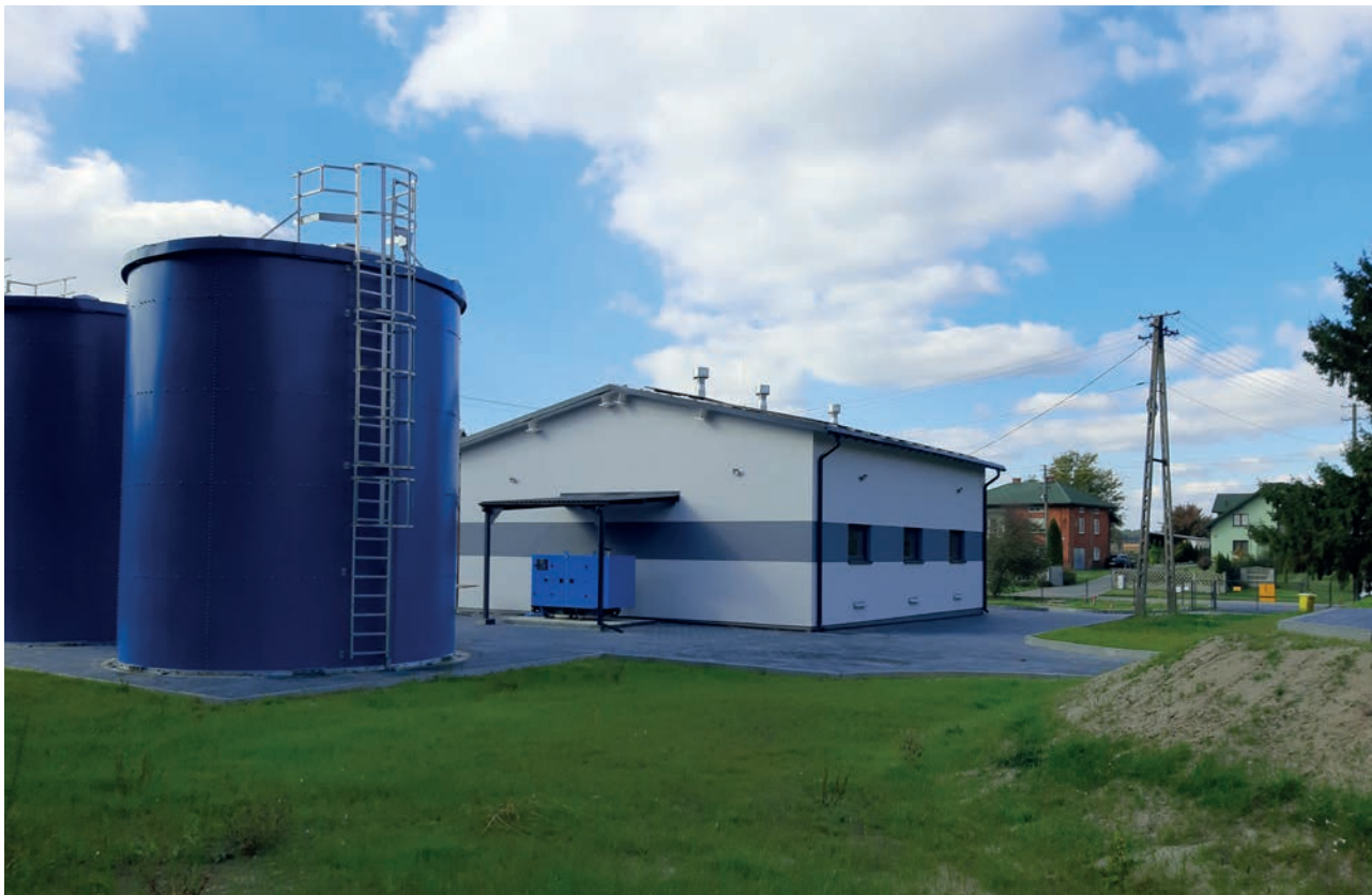
Stacja Uzdatniania Wody w Choszczowie
